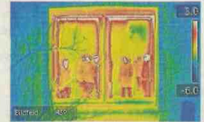
Das mit der Thermografiekamera aufgenommene Bild gibt Aufschluss über den Wärmeverlust .
